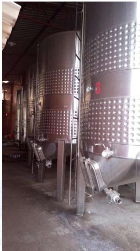
Tanque de Aço Inox
