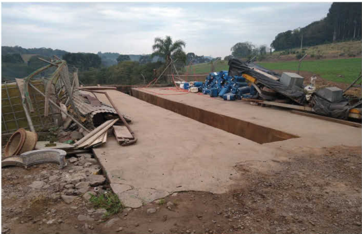
Vista da rampa de lavagem de veículos.
