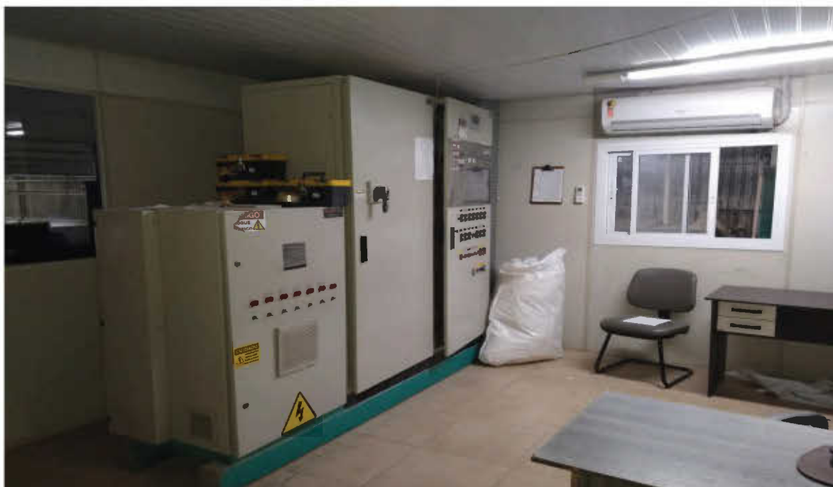
Sala interna ao Mezanino de Controle, com quadros de comandos dos equipamentos.
