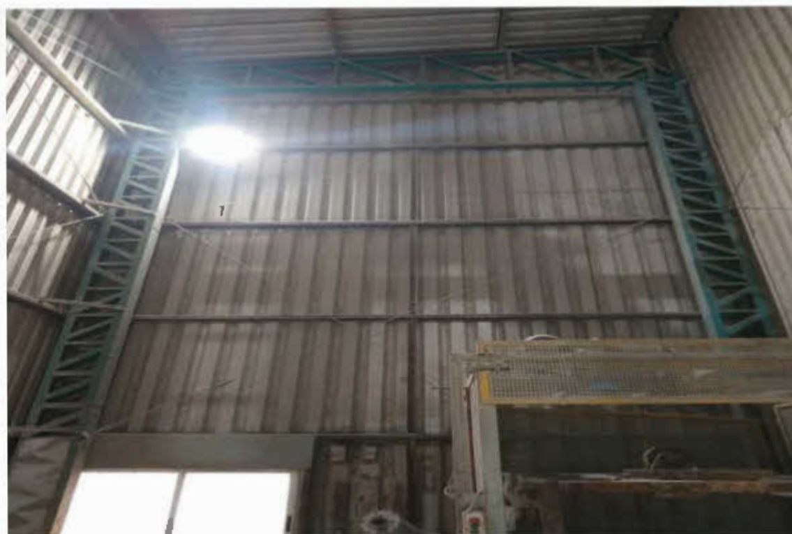
Vista da estrutura metálica do pavilhão e do fechamento lateral. Do lado direito abaixo, vemos o elevador de insumos.
