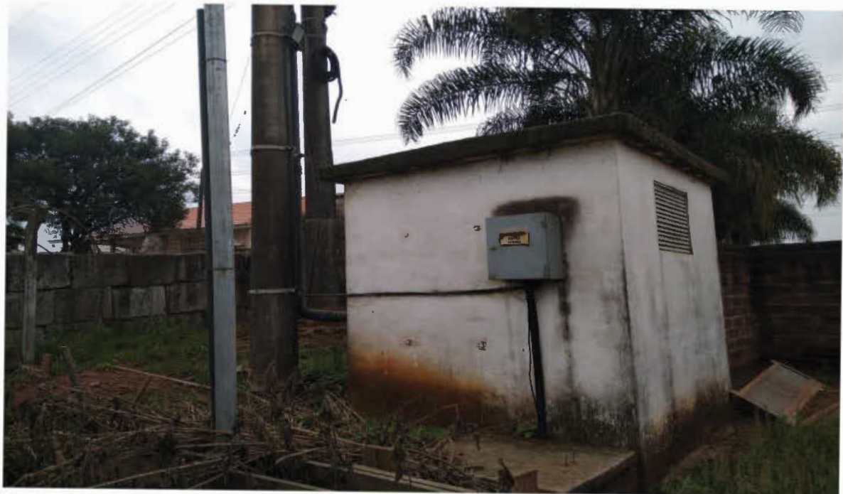
Casa de medição de energia.
