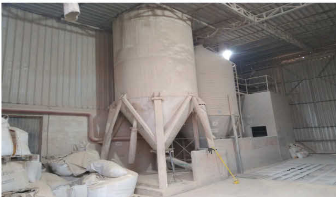
Vista interna da área da Moega e silos elevados instalados internamente a fábrica.
